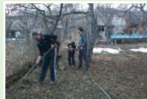
Жители общин кладут трубы, чтобы подвести воду до с. Бузал, Джавский район, май 2012.
